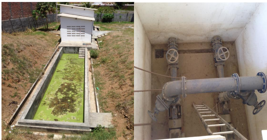
Figura 11. Estação Elevatória de Esgotos Fonte: CASAL/2014
