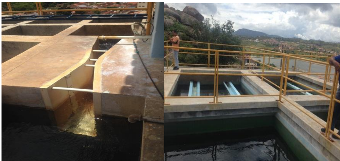
Figura 5. Estação de Tratamento de Água Fonte: CASAL/2014
